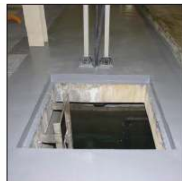
Възстановен и защитен под при първокласно изпълнение
