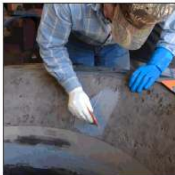
Ремонт на повредата с възстановяване на оригиналните размери с бързотвърдяващ полимер Belzona® 1221
